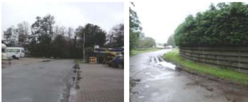
Gaten en scheuren in het wegdek
